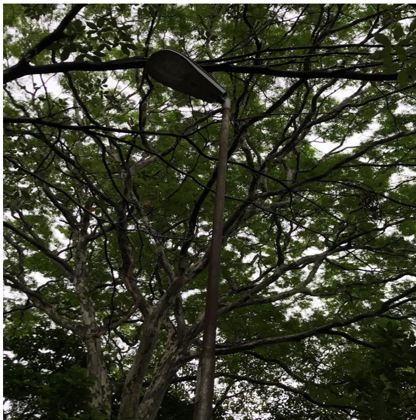
Figura 22: Poste de iluminação do Parque
